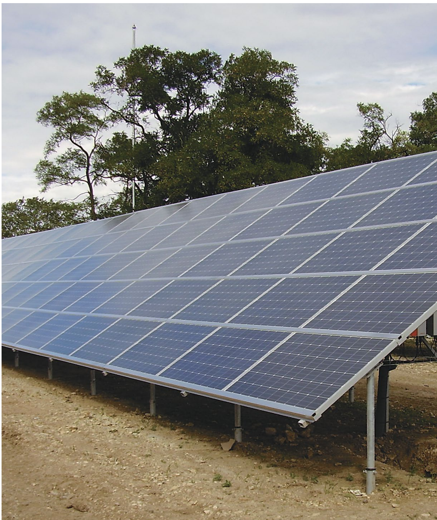
Referenceinstallation i Vrapice (Tjekkiske Republik): 1 MW nominal udgangseffekt – 4320 solcellemoduler – 180 strenginvertere.
