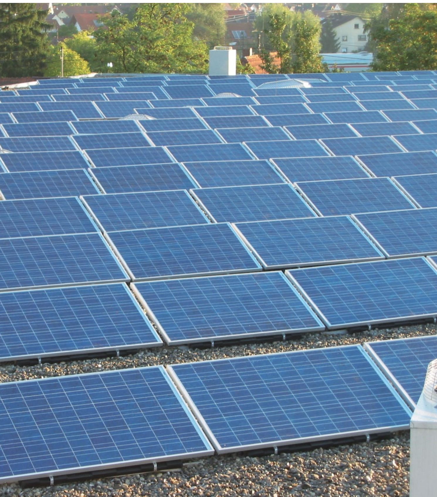
Fotovoltaisk installation hos Delta i Teningen (Tyskland): 46 kW nominel udgangseffekt – 205 solcellemoduler – 15 strenginvertere.
